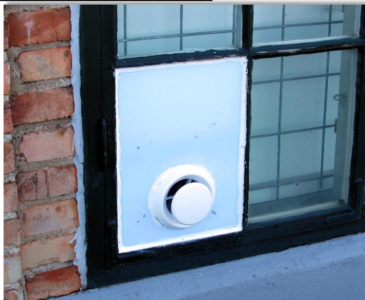
Utblåset klart från AC som nu är installerad vid J35 simulatorn.
